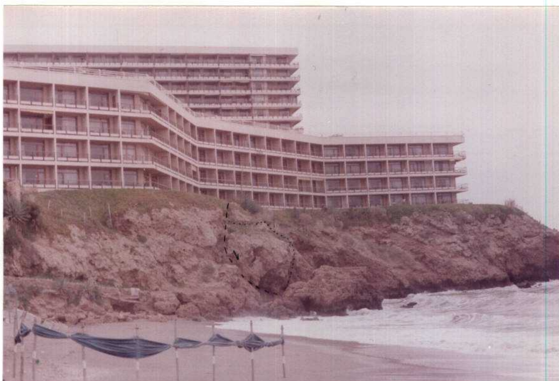
FOT. nº 1. Vista general del sector Sur de la Punta de Torremolinos. Con trazos negros, marcada la zona inestable. Obsérvese, la situación del Edificio "Castillo de Santa Clara" y el estado de la mar.
