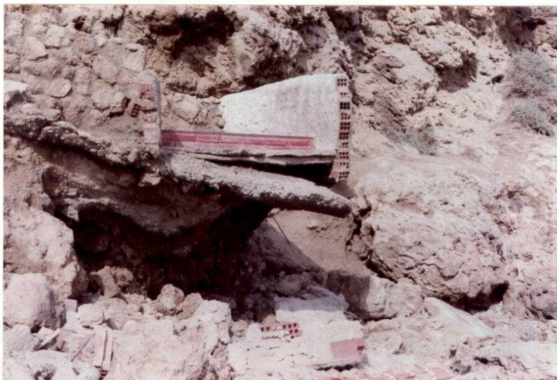
FOT. nº 12. Daños en el acceso a la playa desde el hotel "Castillo de Santa Clara", situado en el límite de los travertinos.
